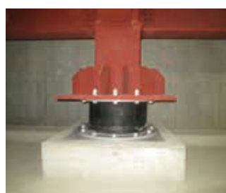
スズケン名南物流センターの免震装置
