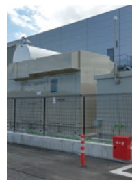
宮城物流センターの自家発電設備
