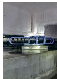
物流センターの免振装置
