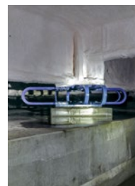
物流センターの免振装置
